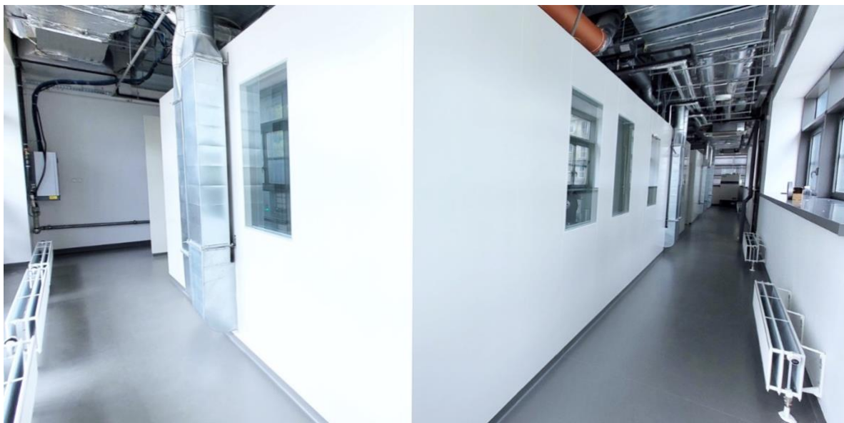
Fot: Pomieszczenie Clean Room w SDS Optic S.A. © SDS Optic
